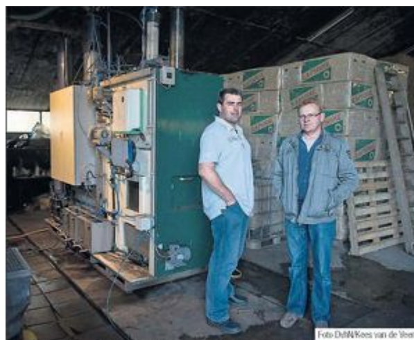
Wilco Hilhorst (l) en Eddie ter Braack bij de proefopstelling van de mestraffinageinstallatie.
