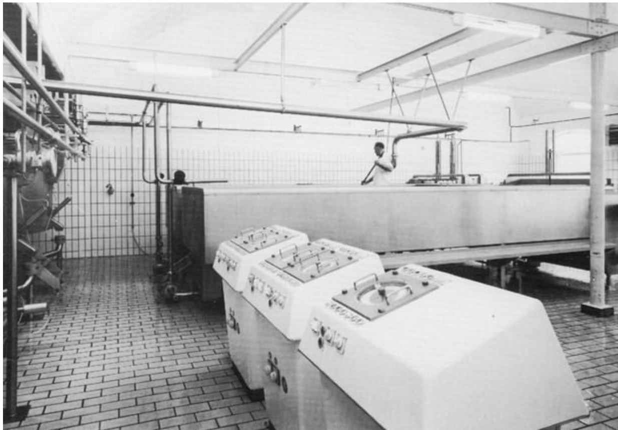
De wrongeldraineerbakken met bedieningsapparatuur voor de kaasbakken. Dit was de eerste automatische installatie in Nederland. Ook deze is gebruikt van 1972 tot 1986
