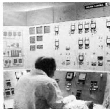
Controle- en schakelpaneel
