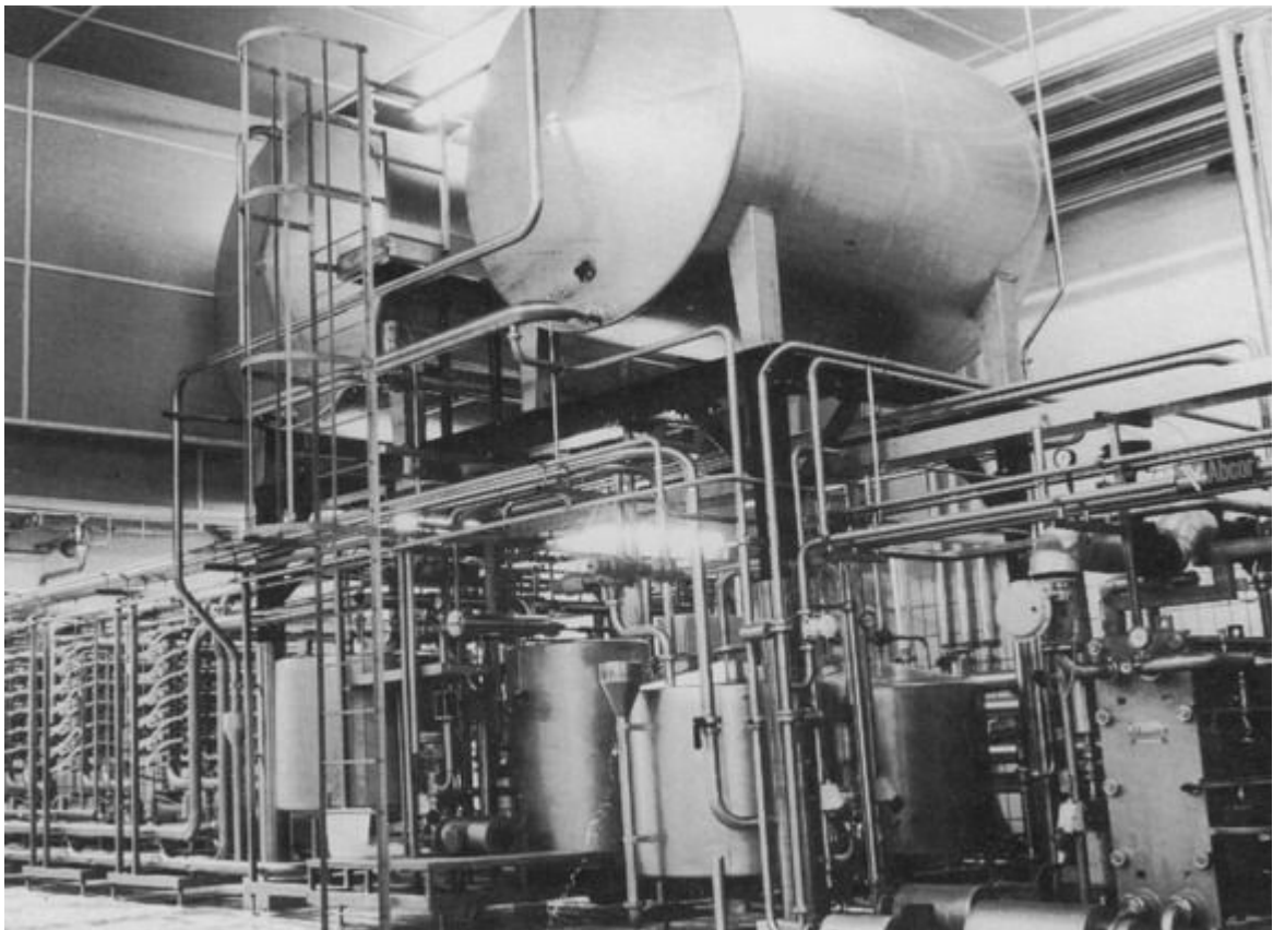
In de in 1987 gebouwde kaashal staat ook de ultra-filtratie apparatuur opgesteld.
