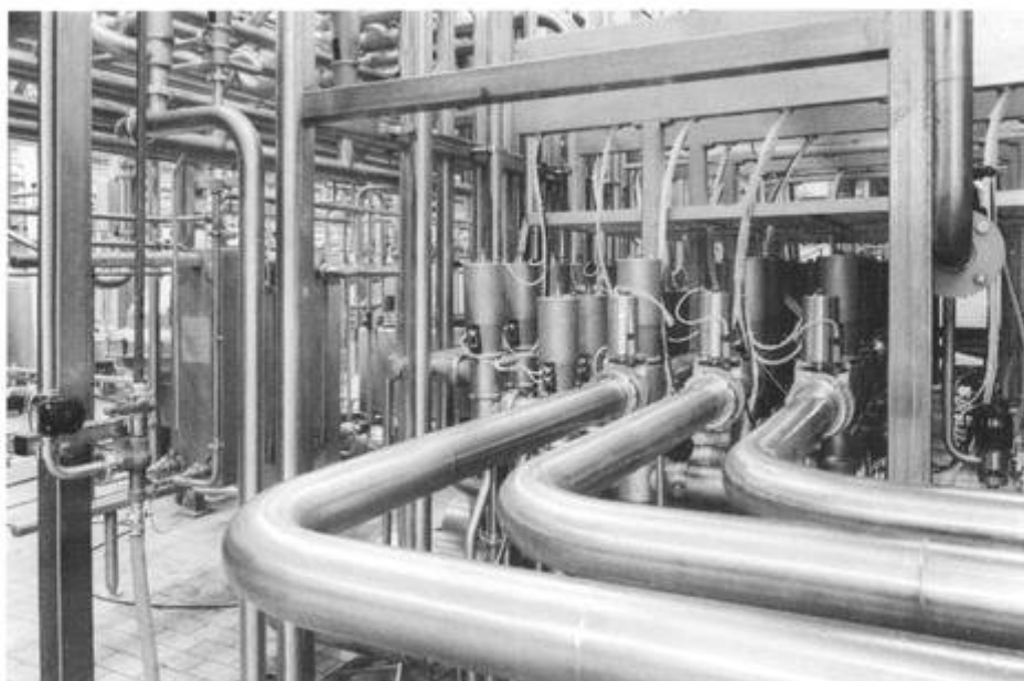
Afsluitercombinatie in centrifugelokaal (verkeersplein)
