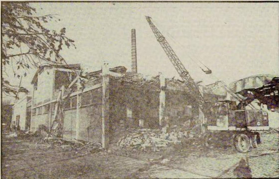
In Middelburg is een begin gemaakt met de sloop van de voormalige melkfabriek.
